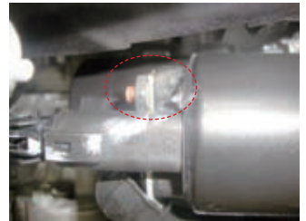
图6 接地线接地不良
