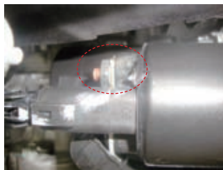
图6 接地线接地不良
