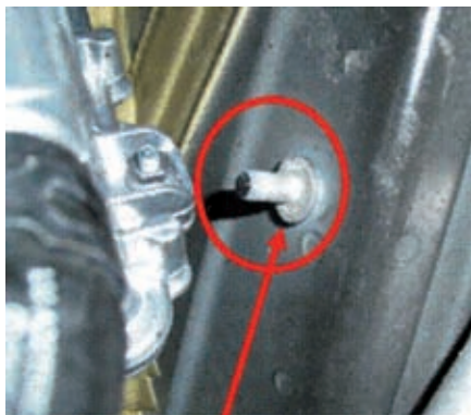
图2 接地点被漆层覆盖
