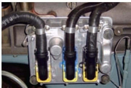
图 23 ECU实机安装
