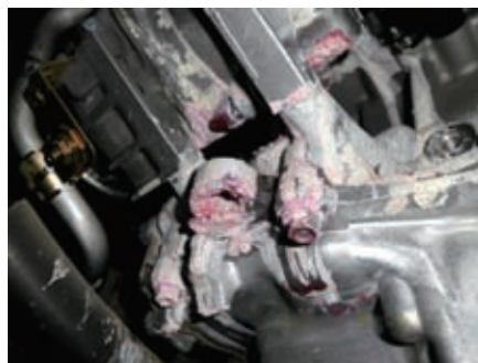
图1 发动机漏水痕迹
