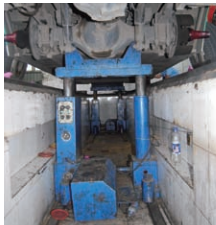
图3 地沟中的固定式举升机
