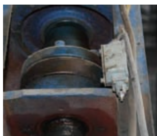
图9 限位开关易损坏
