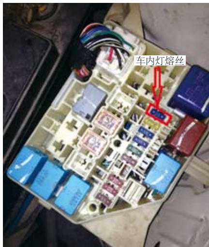
图3 造成遥控偶发性失效的故障点位置
