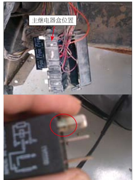
图3 主继电器盒位置与严重锈蚀的主继电器
