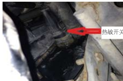
图3 热敏开关安装位置
