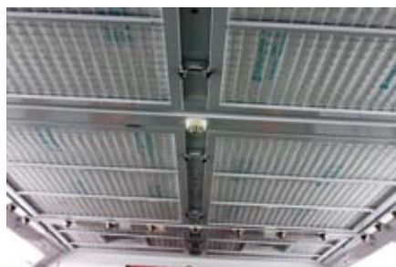
顶部空气净化部分
